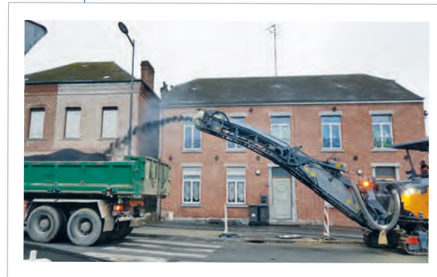
Rond-point de la Cloche d'or Travaux réalisés par le département du Nord : grattage de la chaussée - Octobre 2020
